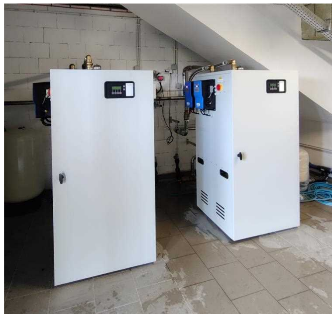
Rys. 2. Instalacja wykorzystania wody deszczowej na cele nawadniania murawy Stadionu w Opolu (źródło: MPI Group Sp. z o.o.)
