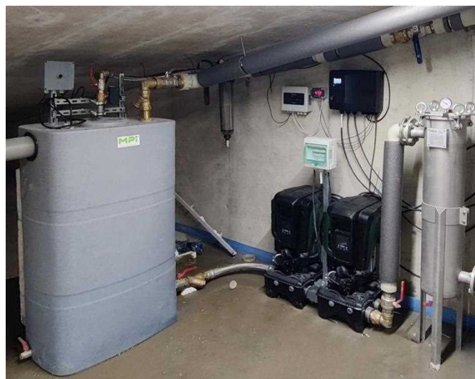
Rys. 3. Instalacja wykorzystania wody deszczowej na cele spłukiwania toalet – Greeneri Park Świnoujście (źródło: MPI Group Sp. z o.o.)
