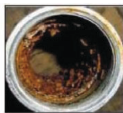
6 miesięcy po instalacji
