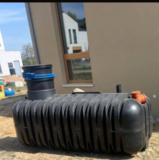
Oczyszczalnia BioFlow - Poznań Morasko
