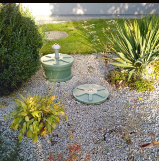
Pokrywa zbiornika i skrzynka techniczna
