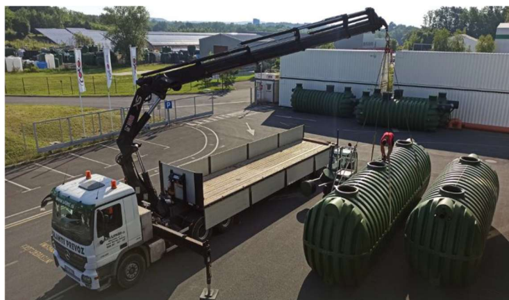
Przykład załadunku/rozładunku zbiornika
