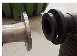
Kołnierz d140 RF i PE gotowy do podłączenia
