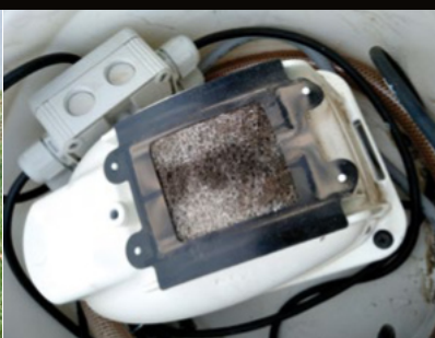
Filtr dmuchawy wymagający czyszczenia lub wymiany
