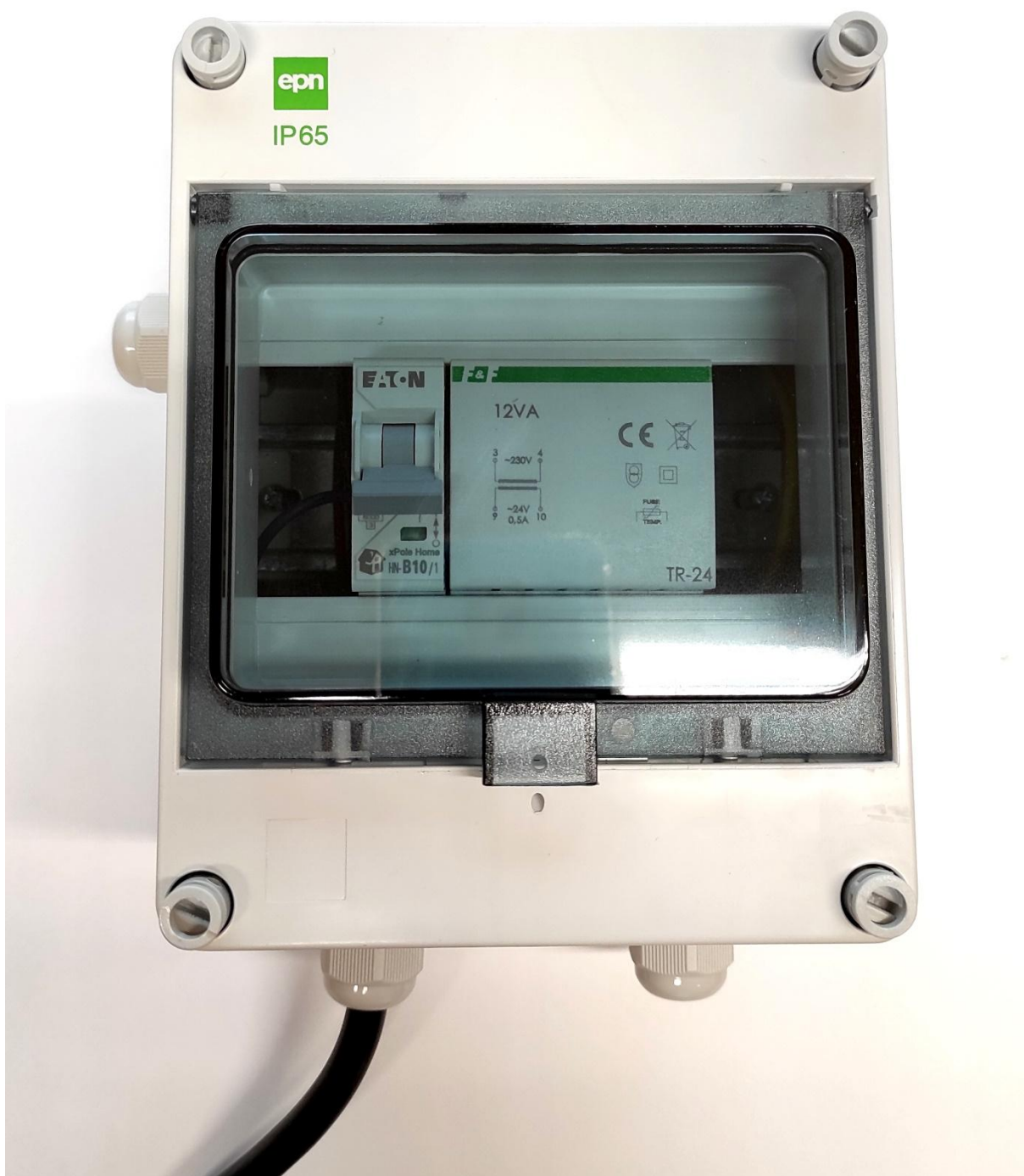
Fot. 1. Skrzynka sterownicza z podłączonym pływką
