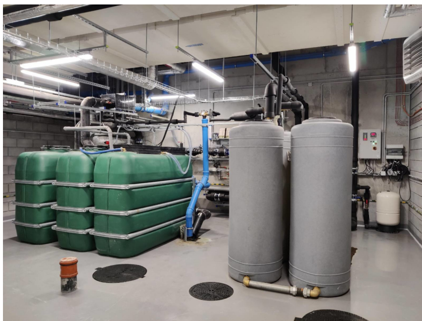
Rys. 3. System odzysku wody szarej i wody deszczowej – Nowy Rynek E w Poznaniu (fot. MPI Group Sp. z o.o.)
