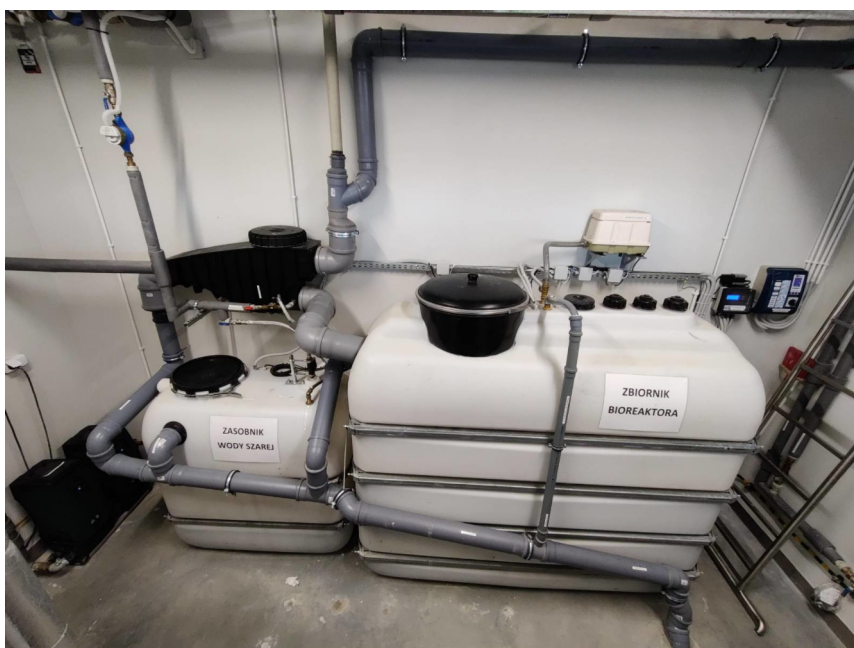
Rys. 2. System odzysku wody szarej o wydajności 1800 l/d – Centrum Logistyczne w Gliwicach (fot. MPI Group Sp. z o.o.)
