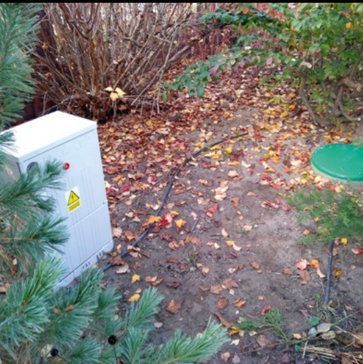
Pokrywa zbiornika i skrzynka techniczna
