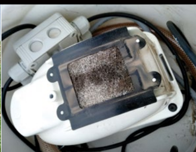
Filtr dmuchawy wymagający czyszczenia lub wymiany
