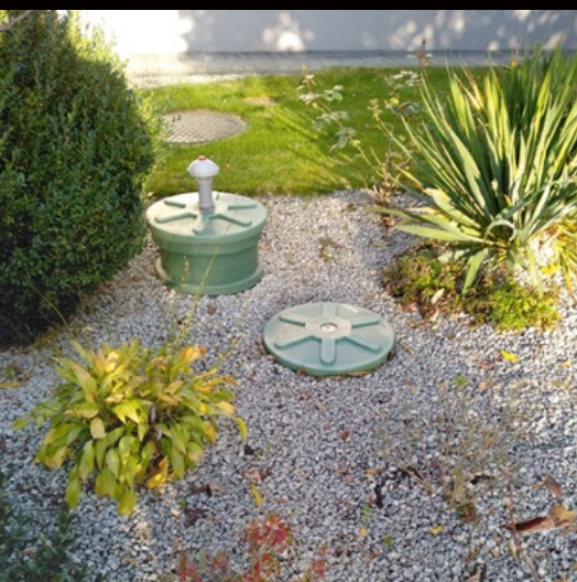
Pokrywa zbiornika i skrzynka techniczna
