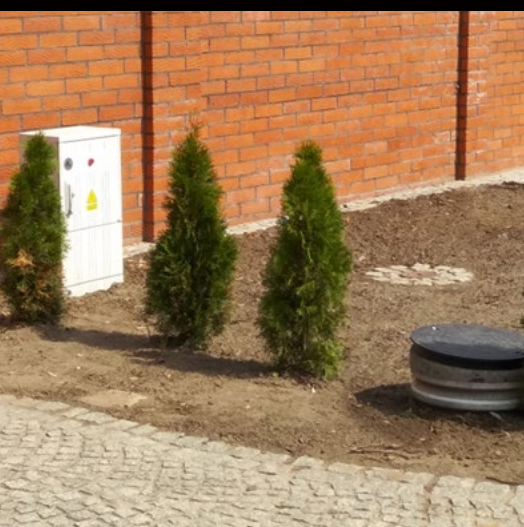
Widok zbiornika i skrzynki technicznej
